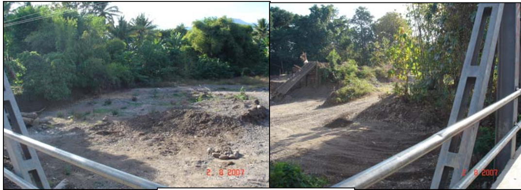
Gbr. 2.1 Kerusakan Sungai Hurung
